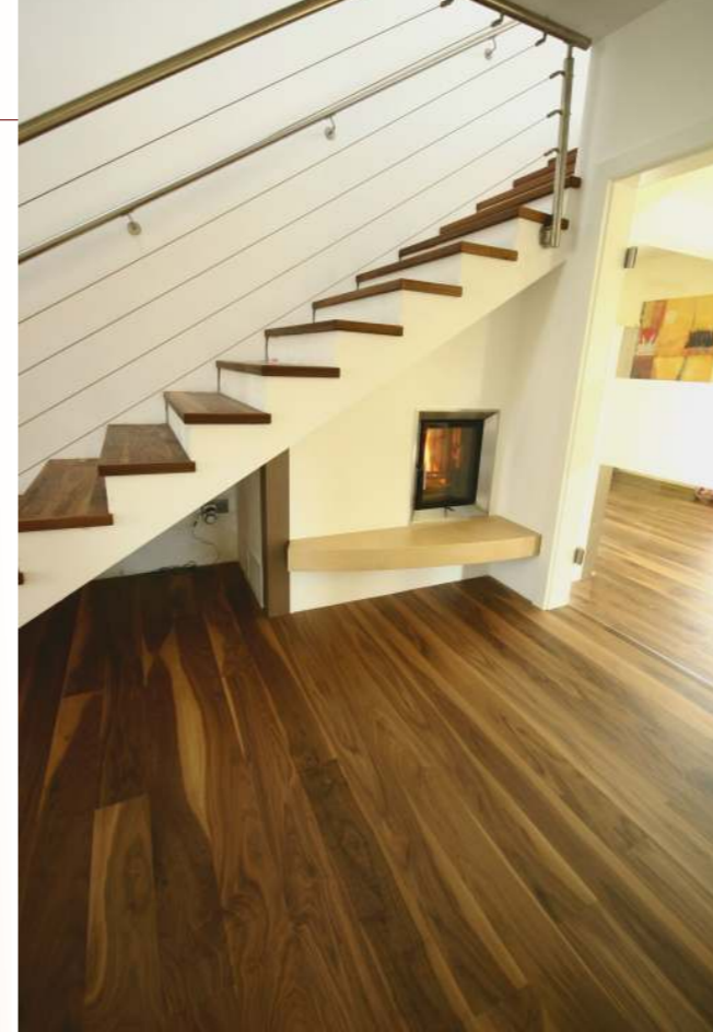
Ein Kachelofen mit einem Heizeinsatz und beidseitigem Sichtfenster im Wohnraum und im Vorzimmer.
